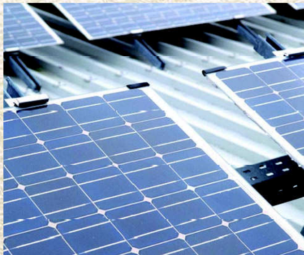
太陽光発電設備
